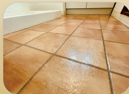
クッションフロア 剥離
